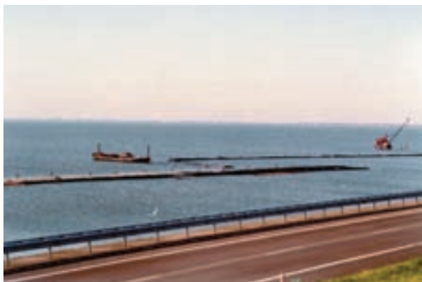
FIGURA 7. Momento de la construcción de una presa secundaria. / FIGURE 7. Moment in the construction of secondary dam.
