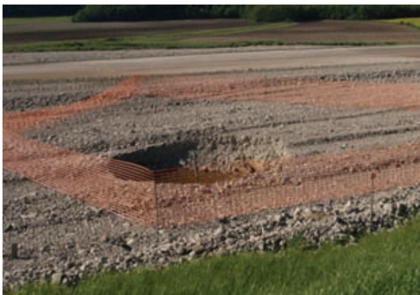
FIGURA 2. Socavón que apareció durante el movimiento de tierras.
