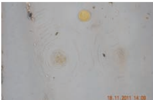
FIGURA 2. Fisuras circulares originadas por punzonamiento en una lámina de PVC llevada al límite de su envejecimiento.
