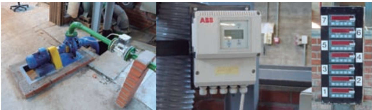
FIGURA 7. Bomba impulsora, caudalímetro y lectores de presión digitales.
