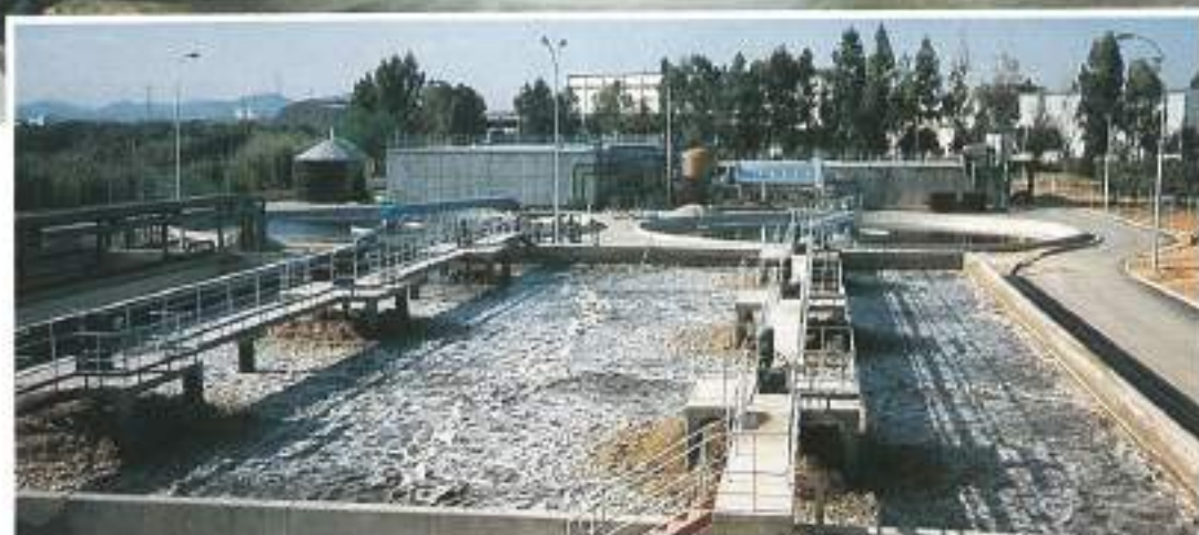
Vista general de la depuradora de Cervezas El Aguila. (Valencia)
