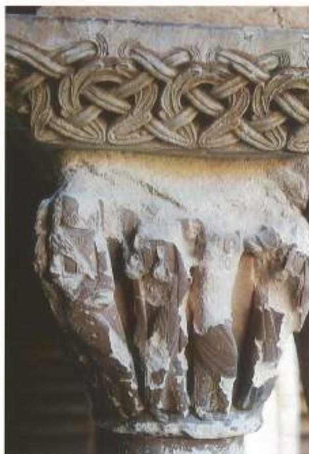
FIGURA 8. Pulverización con un grado de erosión importante en capitel 18.
