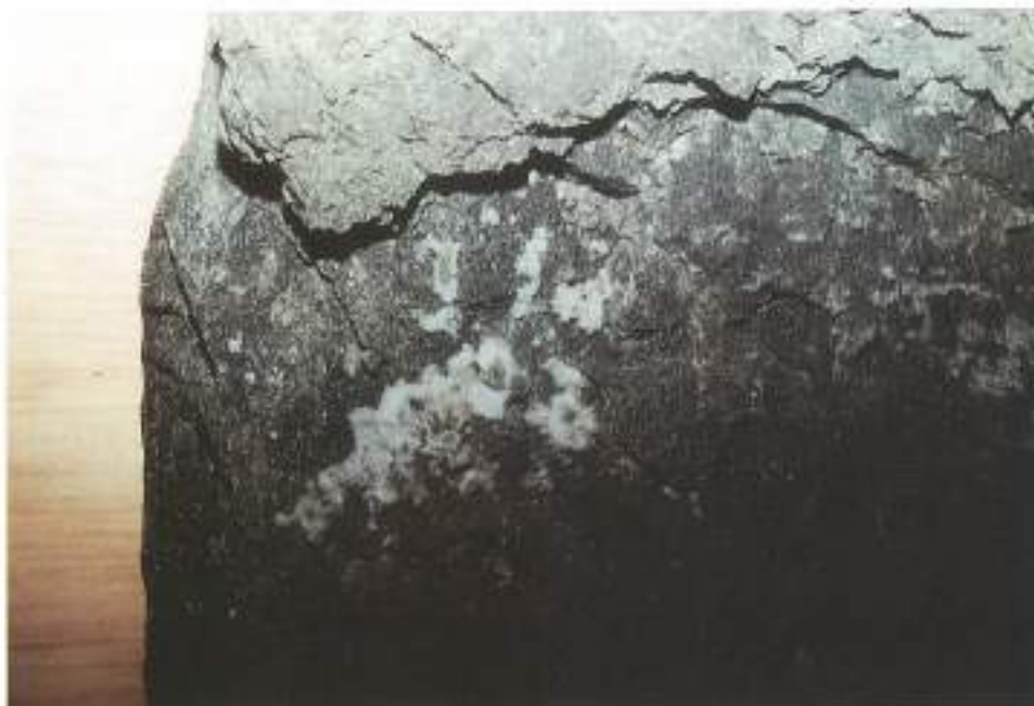
FOTO 4. Detalle de la descomposición que sufren las losas de pizarra debido a la cristalización de sales.
