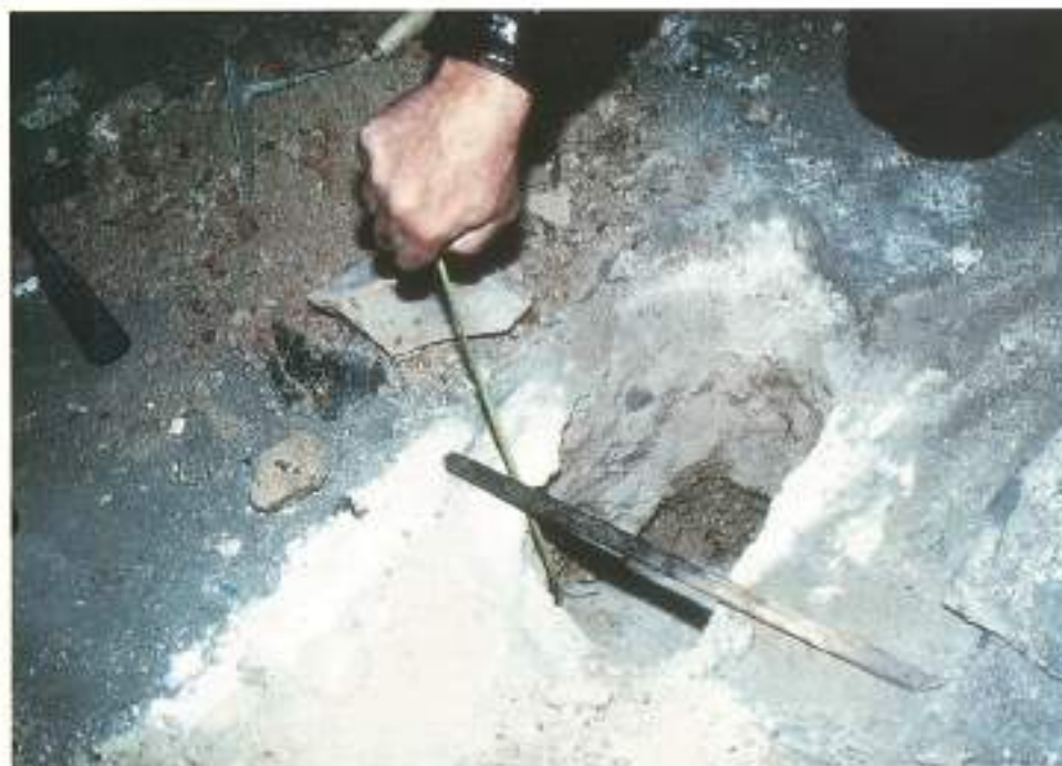
FOTO 5. Toma de muestra del mortero de nivelación. Efectuando una pequeña corte aparecía, bajo el mortero, un relleno artificial de arena con cascotes (trozos de pizarra, mármol, madera, cascotes de cuarzo, etc).
