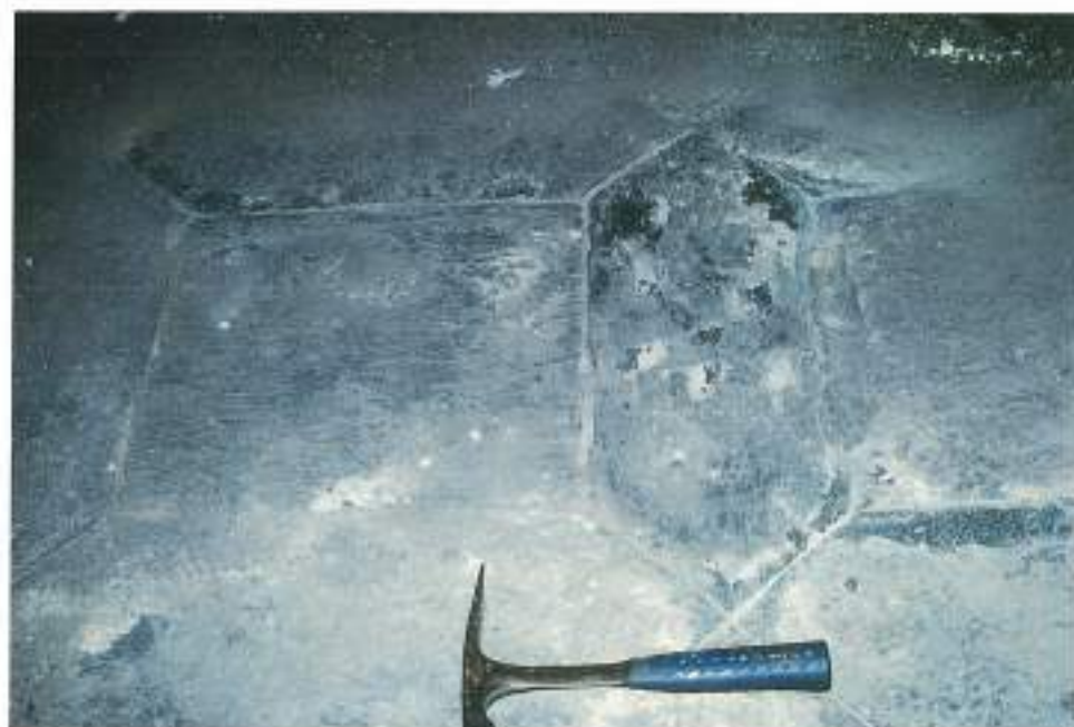
FOTO 3. Acumulación de sales de color blanquecino en la superficie de las losas del crucero. Bajo ellas se encuentra la cripta que durante mucho tiempo ha permanecido cerrada y encharcada.
