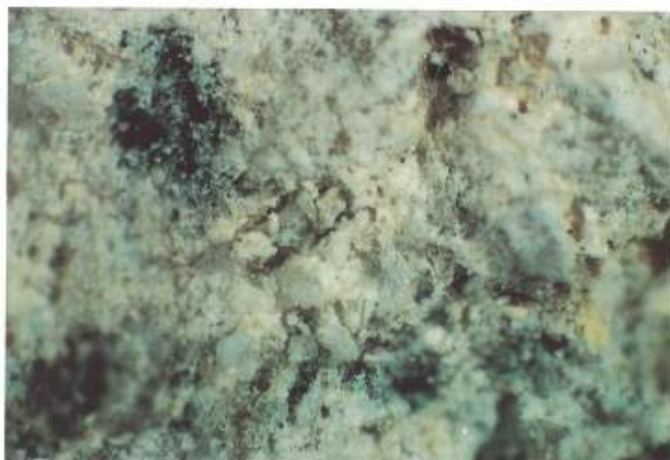
FIGURA 9. Detalle de la colonización biológica que interesa fundamentalmente la zona de matriz cementante.
