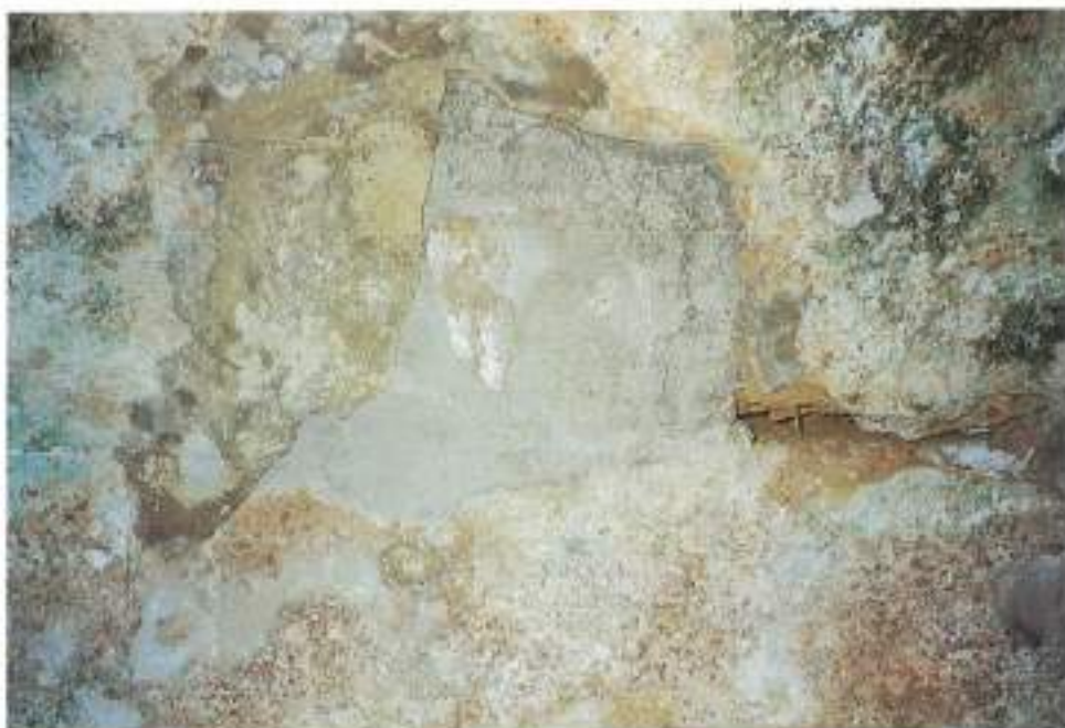
FIGURA 6. Detalle de la situación general de los estucos en el Mausoleo Circular. Zona de extracción de la muestra C-12.
