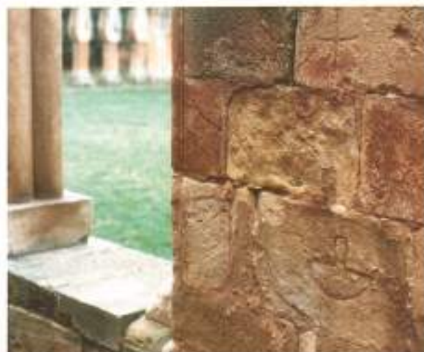
FOTO 11. Desplacado en los sillares de uno de los pórticos ciegos entre dos arcos.
