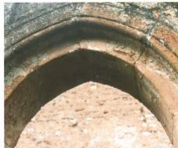
FOTO 12. Detalle de alteración cromática y desplazado de uno de los arcos.
