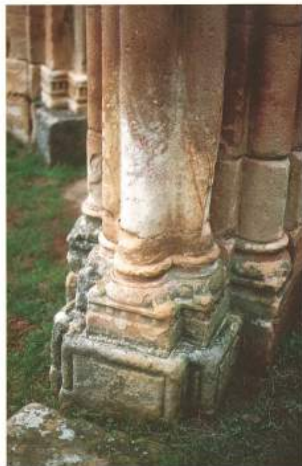
FOTO 10. Arenización en una de las columnas del Claustro.
