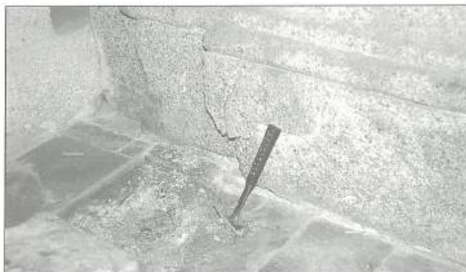
FIGURA 7. Base de la columna izquierda de la Capilla del Patrocinio. Aspecto de los resultados de los procesos de arenización, desplacada, formación de sales y fragmentación de sillares.
