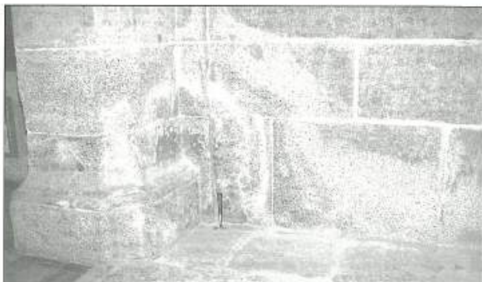
FIGURA 8. Capilla del Patrocinio. Columnata derecha. Aspecto del efecto de humedades y formación de sales.
