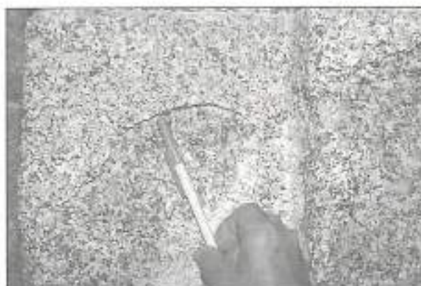
FIGURA 15. Formación y desprendimiento de placas en Adamellitas biotíticas, por efecto de ciclos de humedad-sequedad sobre sillares.
