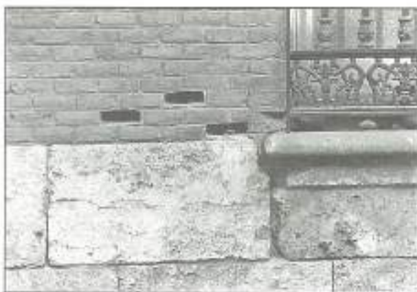
FOTO 4. Pérdida de ladrillo en la zona de encuentro del zócalo con la fábrica (fachada de la iglesia, calle de Santiago).
