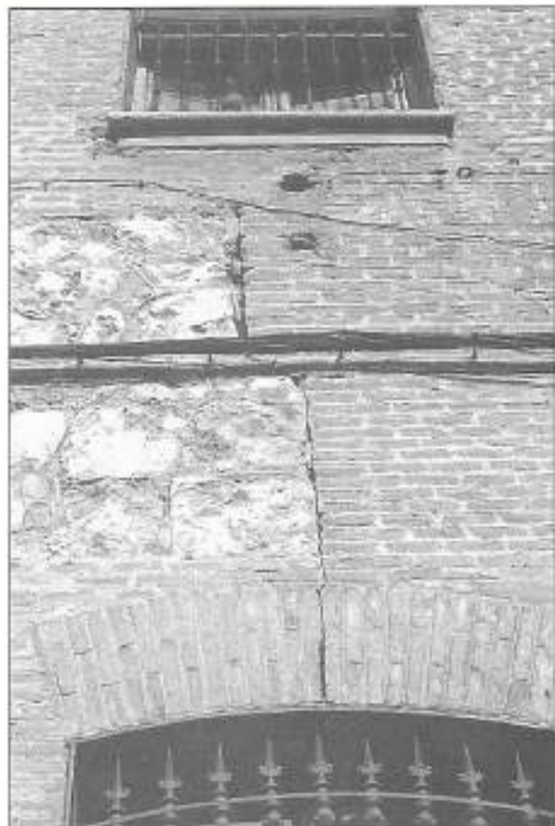
FOTO 8. Fisuras debidas a fenómenos térmicos [fachada de la plaza de las Bernardas].
