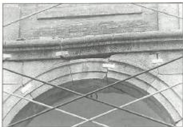
FOTO 7. Movimiento de las dólulas de granito de un arco del claustro.
