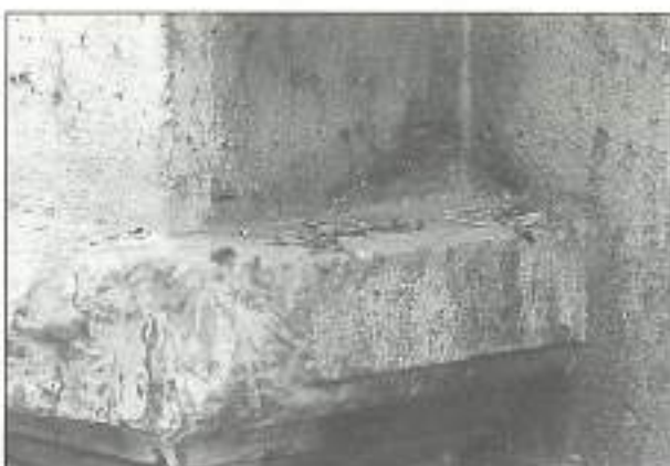
FOTO 6. Deterioro biológico originado por las excrementos de las aves sobre una pilastra de la portada de caliza de la iglesia.
