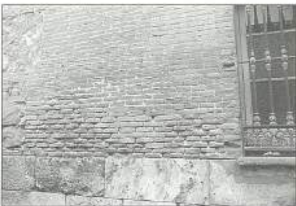
FOTO 5. Pérdida de mortero debido a la acción del agua.
