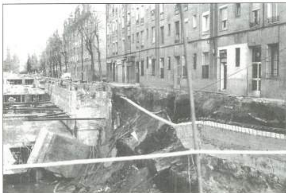
FOTO 1. Vuelco de una pantalla por pandeo de los codales. Obsérvese el pozo de cimentación desplazado.
