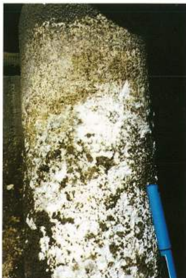
FIGURA 7. Eflorescencias en la base de la linterna del Sarmiental.
