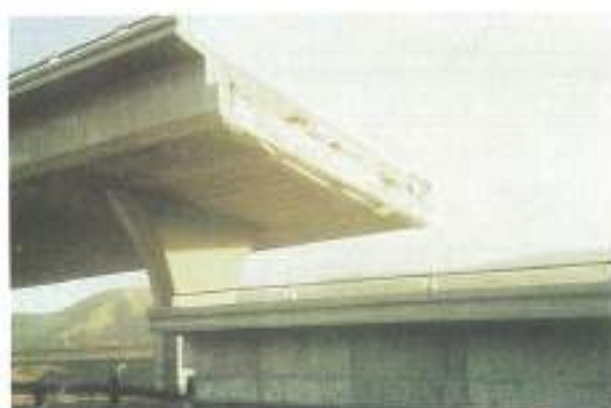
FIGURA 20. Enlace I-5/SR-14. Se. tablero caído desde apoyo a media mañana dañado en su parte inferior.
