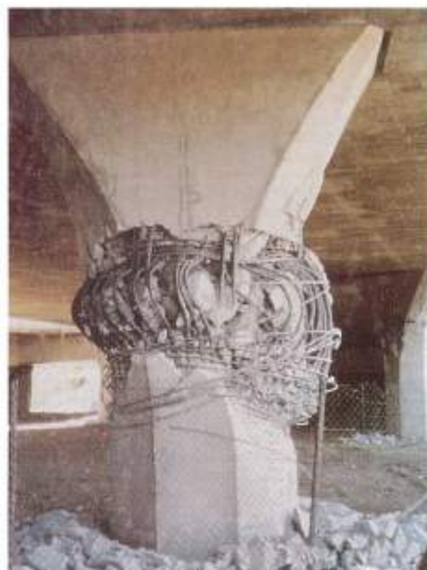
FIGURA 15. I-118. Mission & Gothic. Rotura de una rótula plástica al inicio de cambio de secciones.
