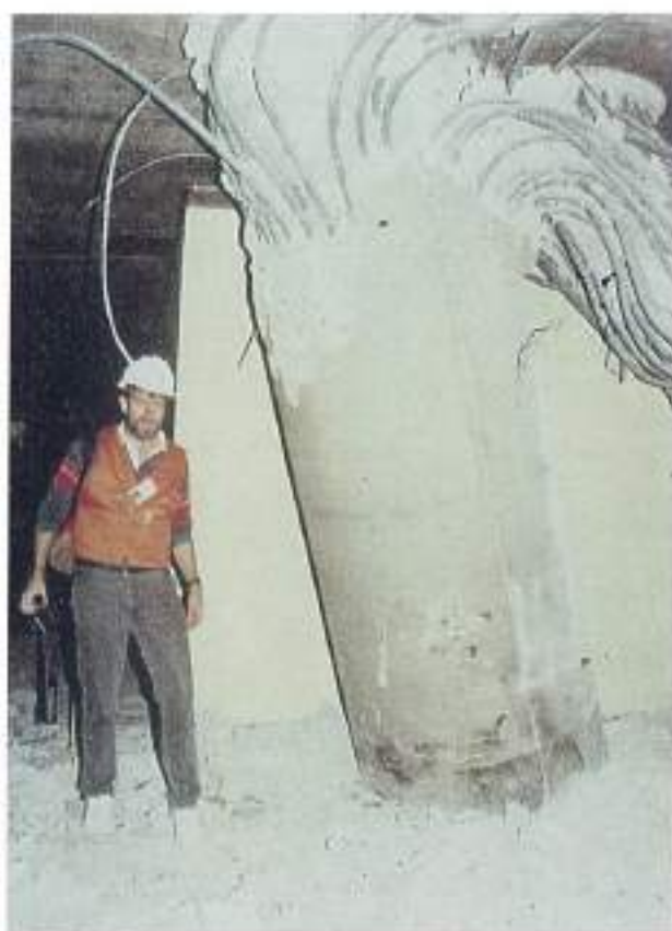
FIGURA 11. Viaducto La Cienega-Venice. Columna 4-A. Obsérvese la rotación de la base.
