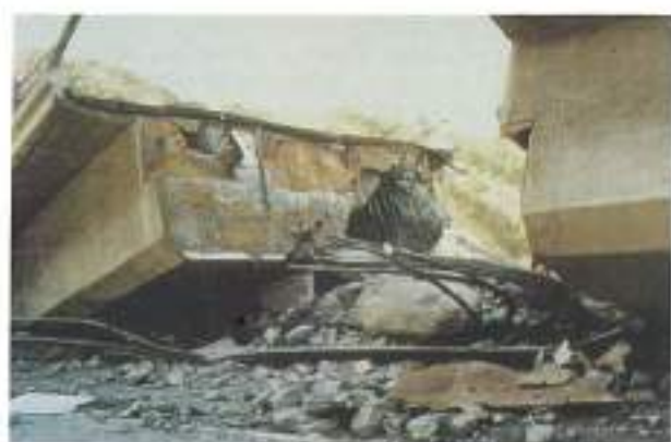
FIGURA 23. Enlace I-5/SR-14 Norte. Rotura de la columna 2.
