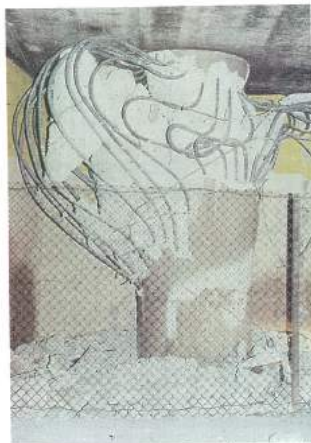
FIGURA 10. Viaducto La Cienega-Venice. Rotura flexión-cortante seguida de agotamiento en compresión.
