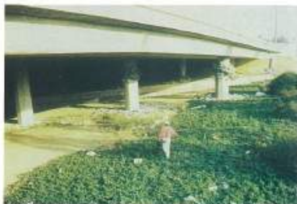
FIGURA 25. Bull Creek Canyon. Vista general de las columnas rotas. Obsérvese el cajero del canal.
