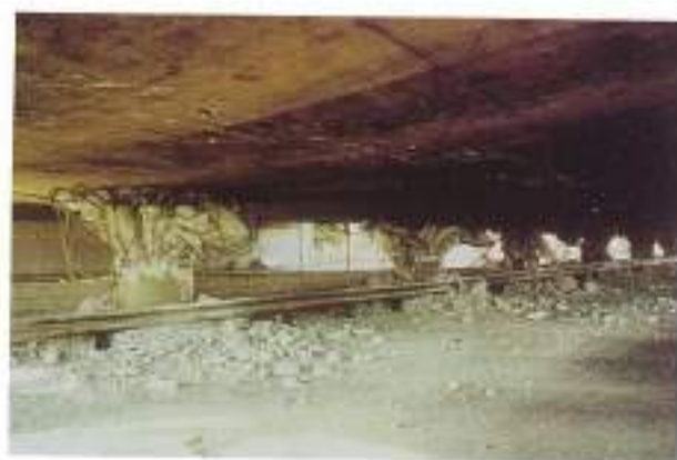
FIGURA 6. Paso inferior Fairfax-Washington. Columnas colapsadas en la alineación 3.
