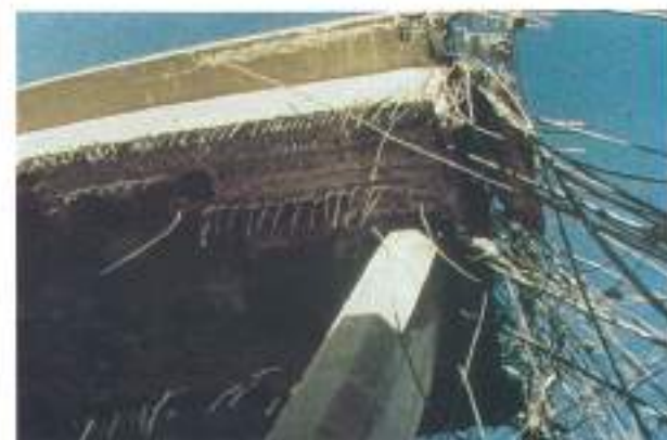
FIGURA 22. Enlace I-5/SR-14 Norte. Rotura del tablero.
