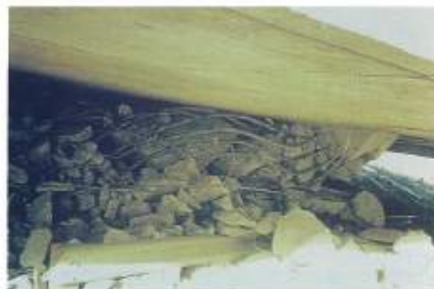
FIGURA 19. Enlace I-5/SR-14 Sur. Rotura de la columna 2 por cortante-flexión en respuesta longitudinal.
