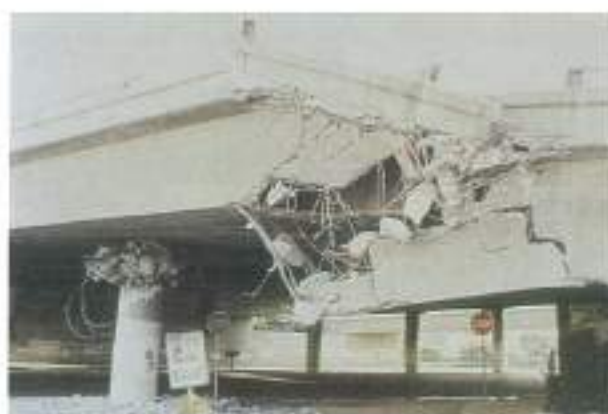
FIGURA 13. Viaducto La Cienega-Venice. Rotura cortante-flexión columna 7 y por flexión del tablero.
