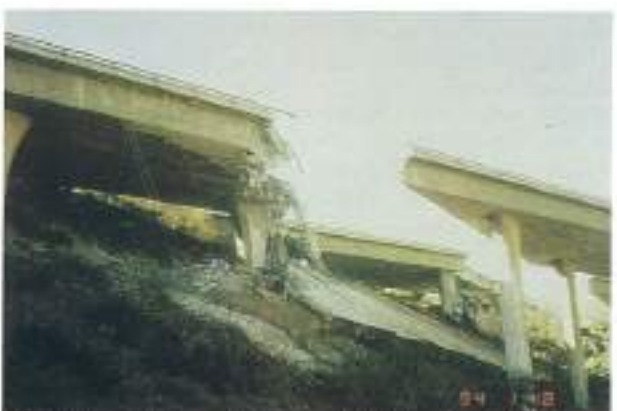
FIGURA 24. Gavin Canyon. Vista general del colapso por pérdida de apoyo. Obsérvese el esvaje.
