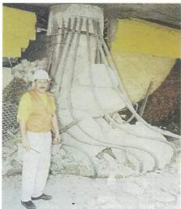
FIGURA 12. Viaducto La Cienega-Venice. Rotura frágil por cortante. Columna 6-A.
