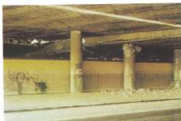
FIGURA 9. Viaducto La Cienega-Venice. Vista general. Rotura de columnas y tablero.
