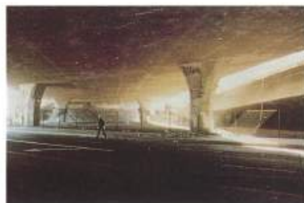
FIGURA 16. I-118. Mission & Gothic. Colapso de un puente y daños en el otro paralelo.
