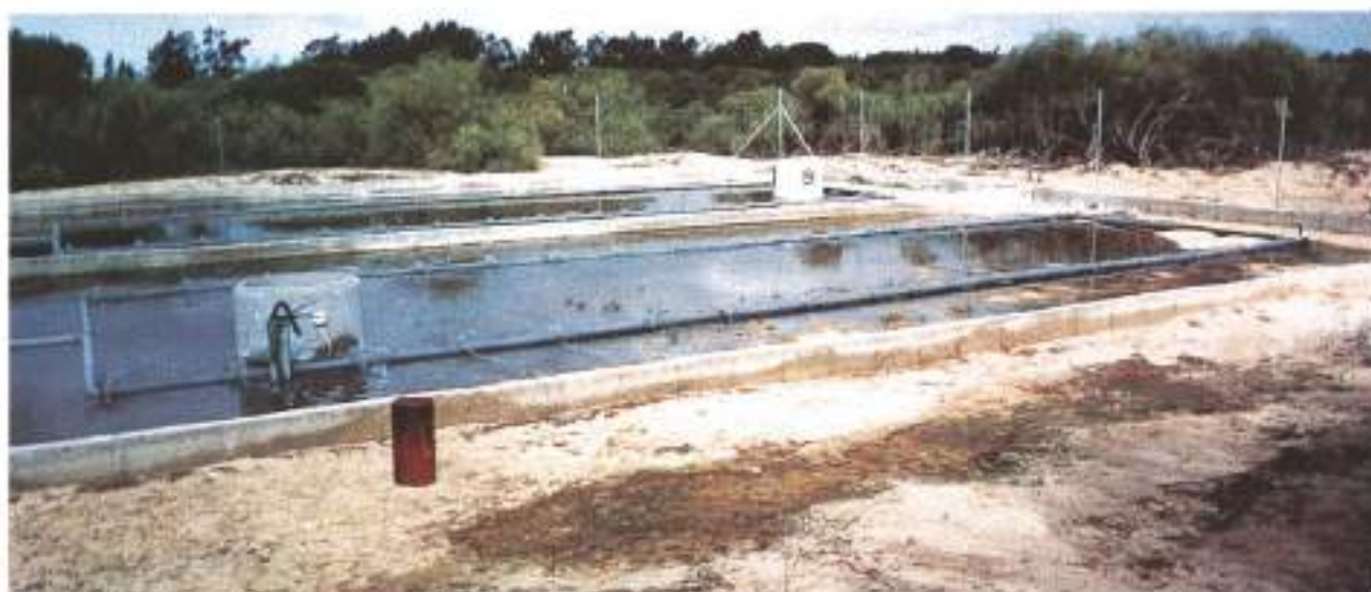
FOTO 4. Infiltración durante la descarga.
