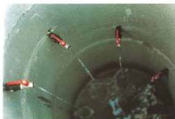
FOTO 3. Percolado fluyendo por los drenajes.
