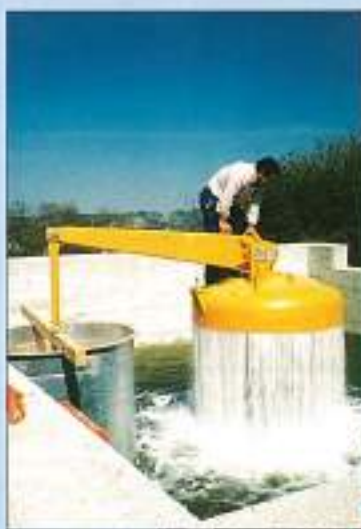
OBTURADOR - REGULADOR DE NIVEL Abastecimiento a Irún
