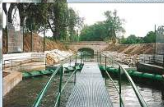
REGULACION DE NIVEL Y DISTRIBUCION Canal del Duero Compuertas AVIS y Módulos de Máscara C
