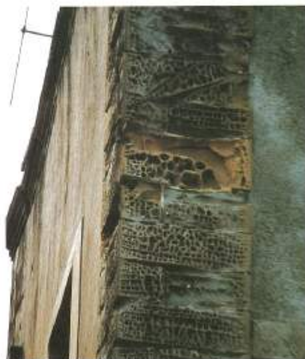
FOTO 2. Alteración alveolar en la torre de la capilla, dando lugar a estructuras en "panal de miel" o honeycomb weathering.
