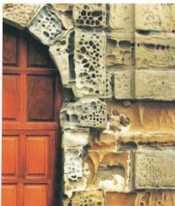
FOTO 3. Patologías más características del edificio. Desarrollo de alvéolos, arenizaciones, abrasiones y pátinas oscuras.
