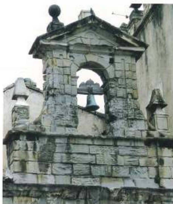
FOTO 4. Procesos de arenización y alteraciones de carácter alveolar en la zona de la espaldaña.
