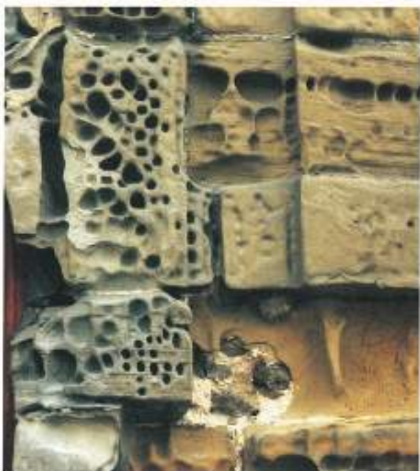
FOTO 6. Alteración alveolar, desarrollada sobre sillares de arenisca. En algunos casos, la arenización pone de manifiesto los morteros de unión.
