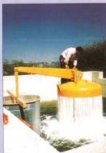
OBTURADOR - REGULADOR DE NIVEL Abastecimiento a Irún
