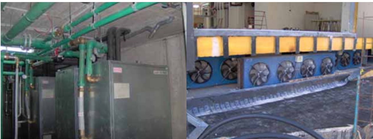
FIGURA 8. Bombas de calor y unidades de aerotermos de la instalación.
