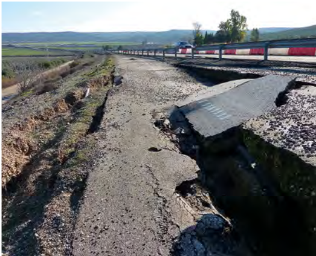
Foto 1. Daños en calzada y arcén de la autovía.
