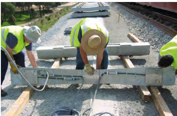
Foto 27. Disposición de células de carga bajo una traviesa.
