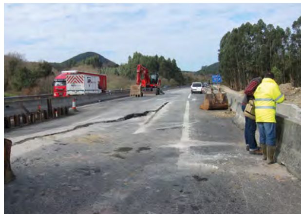
Foto 5. Grietas de la calzada.
