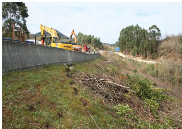
Foto 6. Vista de grietas en el terraplén.
