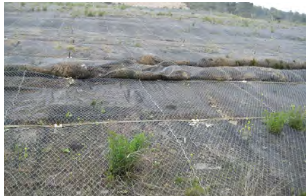
Foto 13. Deformación de la superficie del desmonte.
