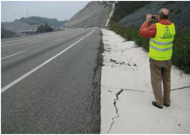
Foto 14. Daños en el pie del desmonte.
