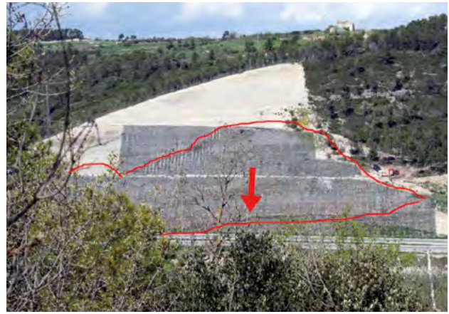
Foto 12. Zona afectada por la inestabilidad.
