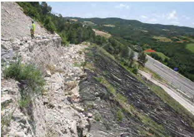
Foto 15. Grieta con salto >2m en berma superior.
