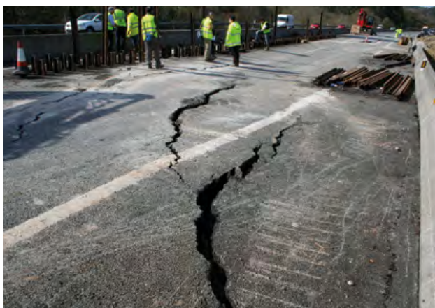
Foto 4. Grietas de la calzada.
