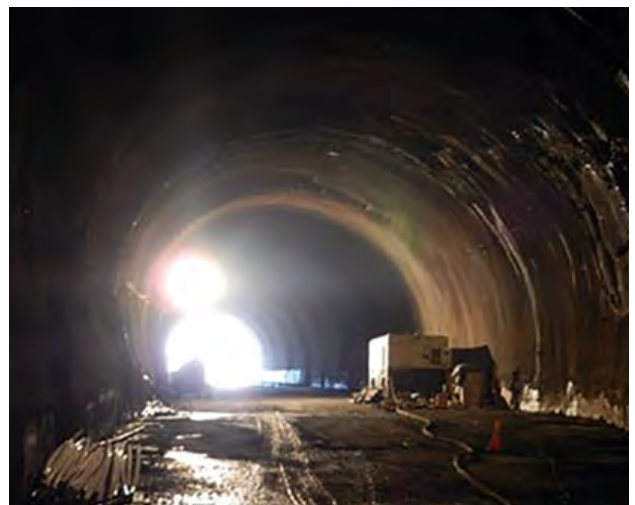
Foto 21. Vista de la distorsión del túnel.
