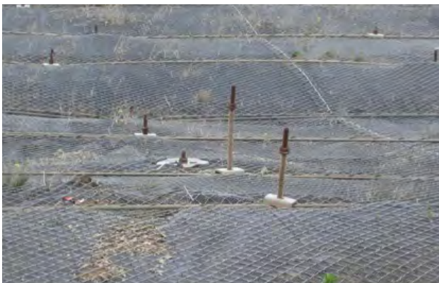
Foto 16. Rotura de bulones.
