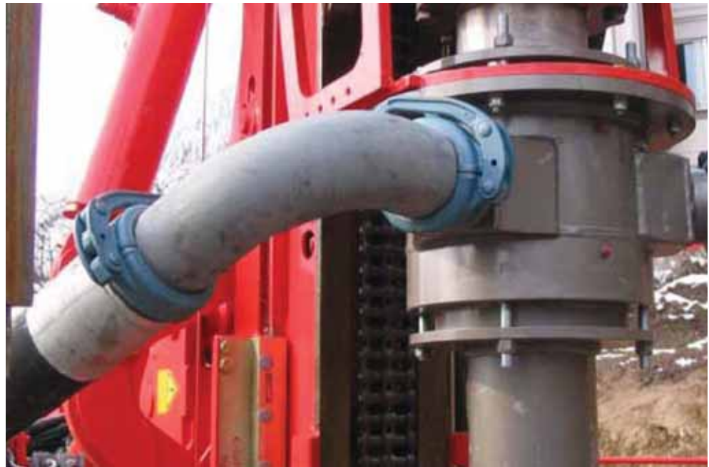
FIGURA 1. Equipo de perforación geotérmica equipado con "preventer" (Fuente: Klemm Bohrtechnik).
