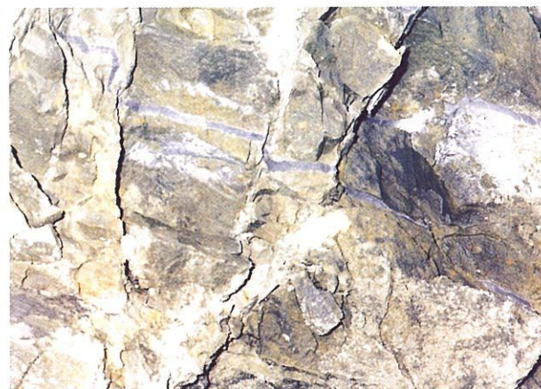
FIGURA 2. Inclusiones de cemento obtenidas con presiones de inyección bajas (menos de 500 Kpa).
