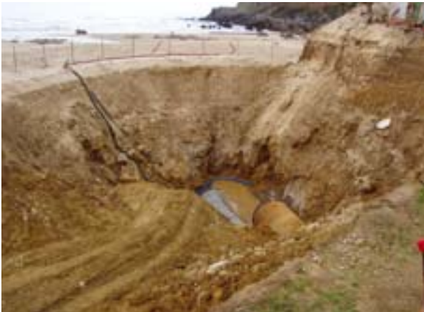
FIGURA 10. Vista general de la duna tras la recuperación de los dos primeros módulos de la microtuneladora.
