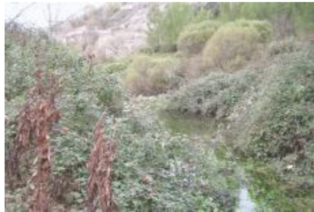
FIGURA 6. Azud colmatado, colonizado por un zarzal. Río Vinalopó (Alicante).
