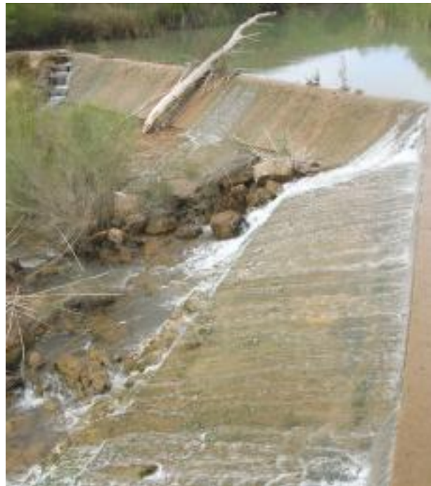
FIGURA 9. Erosión en la base de un azud. Río Mundo (Albacete).
