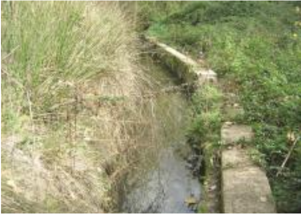
FIGURA 20. Canal de derivación sin uso.
