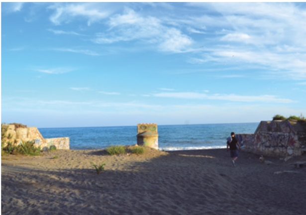
Figura 24. Restos de pila, estribos y muros de protección contra el oleaje del puente de la rambla de Santillán. Fotografía del autor.
