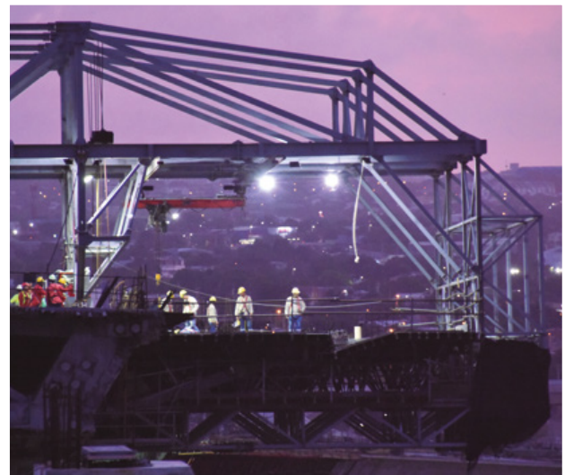
Figura 26. Carro de alas en viaductos de acceso.
