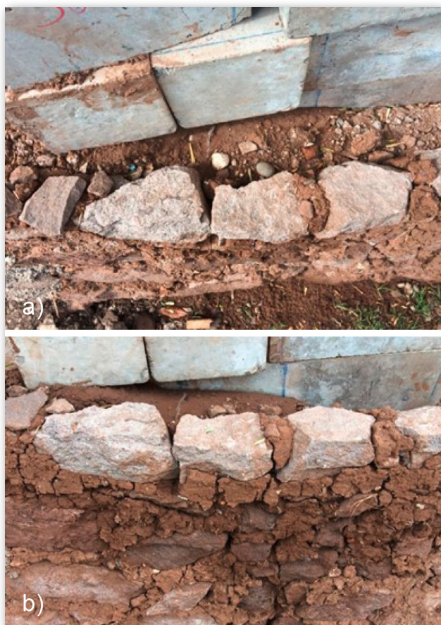
Figura 6. a) Desprendimiento del mortero con las humedades pétreas en el muro de barro saturado y sobrecargado. b) Muestra el pandeo del muro de barro en la parte superior del muro y también se observan las grietas en el mortero.
