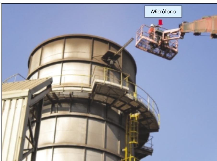
FIGURA 6. Realización de medidas de presión para caracterizar la potencia acústica de focos industriales.
