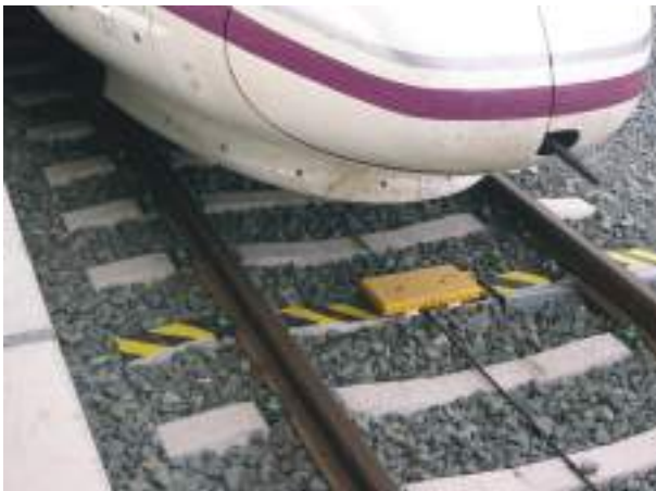
FIGURA 1. Eurobaliza instalada en la vía.
