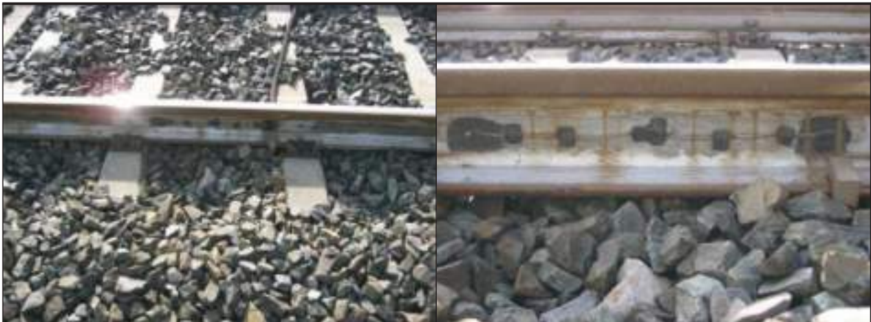
FIGURA 3. Bandas de cortante en el alma del carril entre dos traviesas consecutivas.
