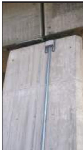
FIGURA 16. Acelerómetros en cabeza de pila del viaducto de Salinetas.
