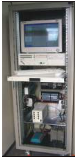
FIGURA 18. Sistema de control y transmisión de datos.
