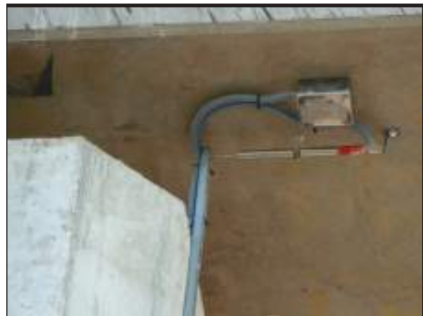
FIGURA 17. Transductor de desplazamiento entre cabeza pila y tablero. Viaducto de Salinetas.
