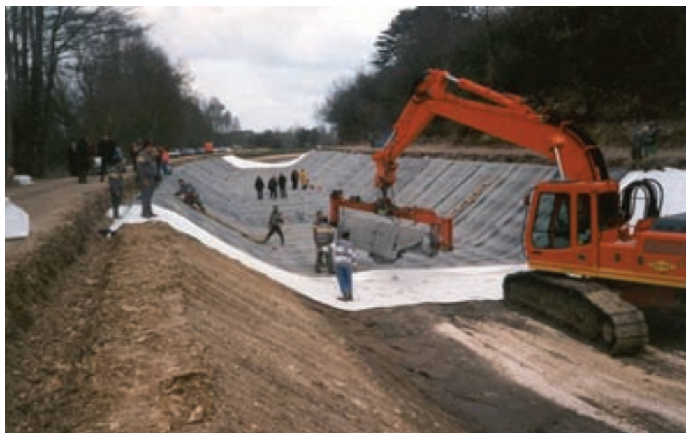
FIGURA 3. Canal revestido con una geomembrana y un geotextil. /
