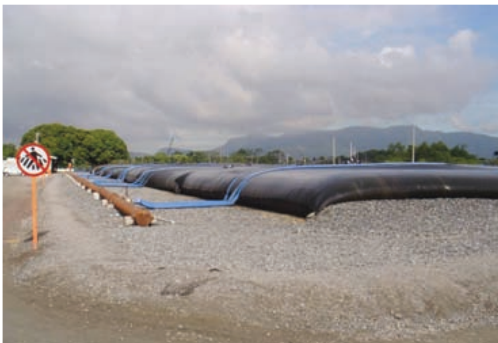
FIGURA 9. Geotubo para decantado de sedimentos contaminados. /
