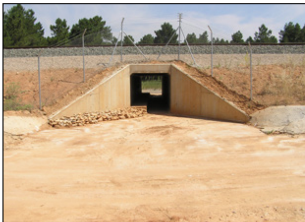
Figura 6. La utilización de los pasos por la fauna cambia con el tiempo, al desarrollarse las medidas de integración ambiental y también debido al acostumbramiento de la fauna a la infraestructura. La imagen muestra un drenaje de tipo marco de 2 m x 2 m, con una banqueta lateral para facilitar el paso seco a la fauna. La banqueta conecta con el exterior mediante un enchachado.
