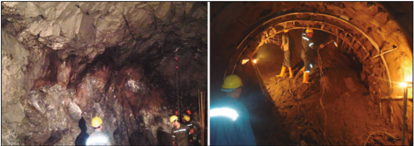
Imágenes 3 y 4. Transición del volcánico a los depósitos aluviales y colapso del túnel Papallacta en la abscisa 0+485 (Cortesía de Astec).
