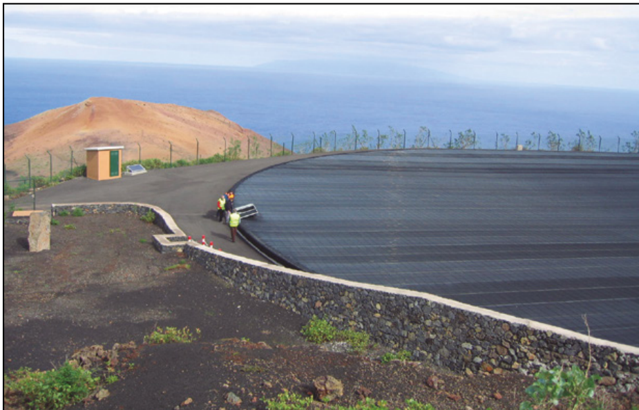
Figura 5. Balsa cubierta de La Montaña del Tesoro, impermeabilizada con PEAD.
