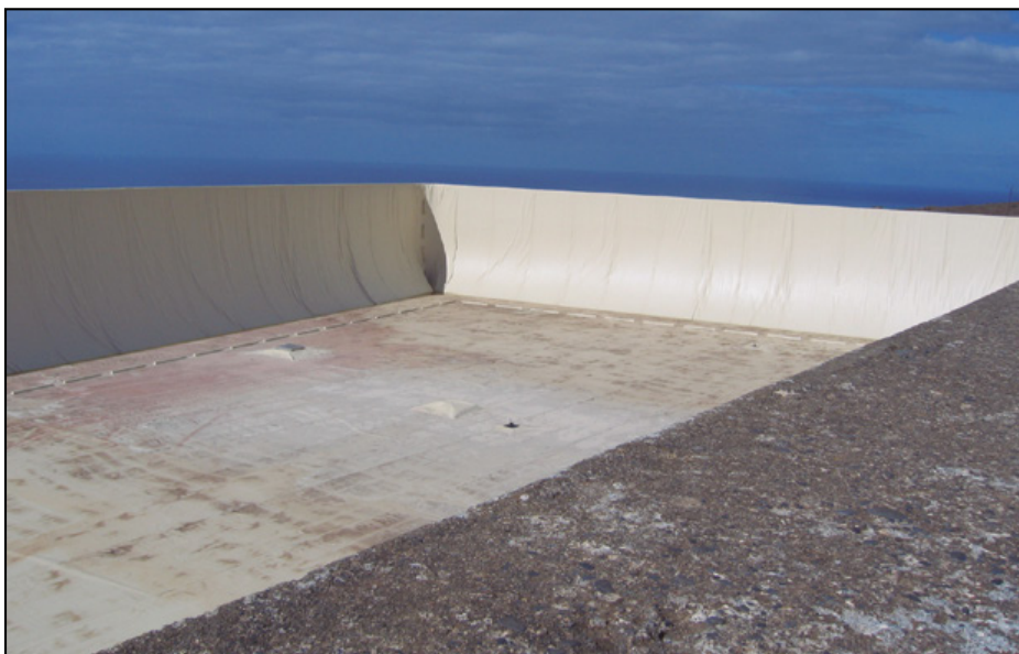
Figura 4. Depósito de Los Cardones con cubierta flotante de PP, en Alajeró, isla de La Gomera.
