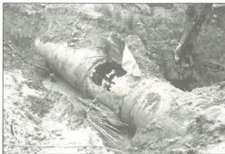
FOTO 1. Explosión de la tubería.
