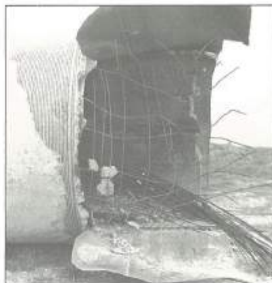
FOTO 2. Tubo en estación depuradora.
