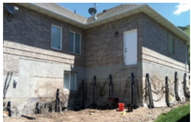
Figura 7. Recalce de vivienda en Salt Lake City (EEUU). Cortesía de Interwest y Magnum Piering Inc, 2017.
