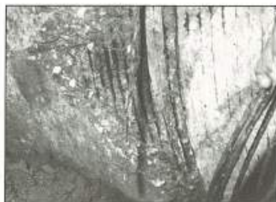
FOTO 14. Zona al lado de la rotura. Obsérvense varillas rotas y la zona descrita.
