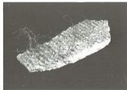
FOTO 18. No existe el papel protector del recubrimiento exterior.
