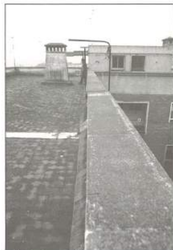
FIGURA 3. Desplazamiento diferencial de unos 4 cm en parte superior de la junta de dilatación.
