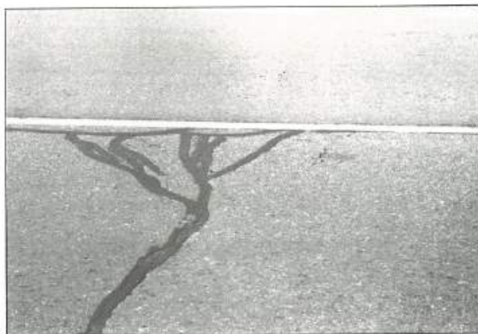
FOTO 23. Grietas de esquina.
