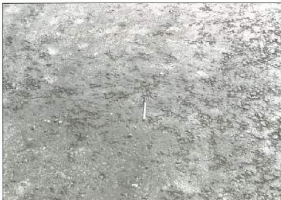
FOTO 18. Detalle del acabado superficial y de la aparición de grietas de retracción.
