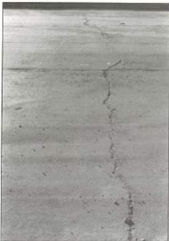
FOTO 21. Pavimento de hormigón compactado sin juntas. Evolución de los grietas de retracción tras mantenerse abierto al tráfico durante un año.
