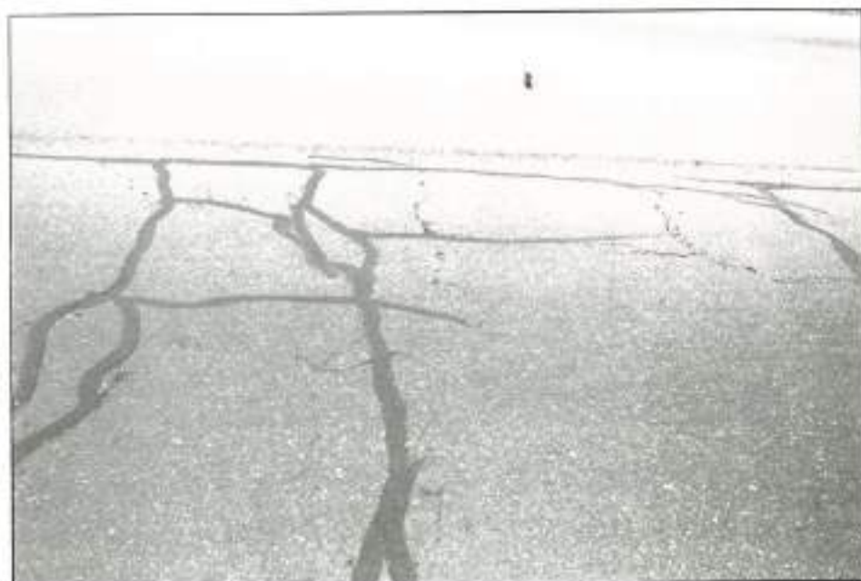
FOTO 22. Reflexión de grietas de retracción no serradas en las capas de aglomerado.
