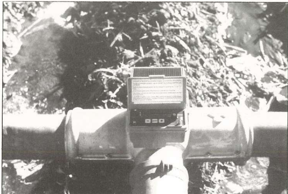
FOTO 2. Válvula de riego por impulsos (detalle del mecanismo automático y del panel fotovoltaico de alimentación).
