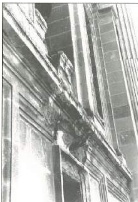
FIGURA 12. Fracturas con desprendimiento de material en la fachada norte.
