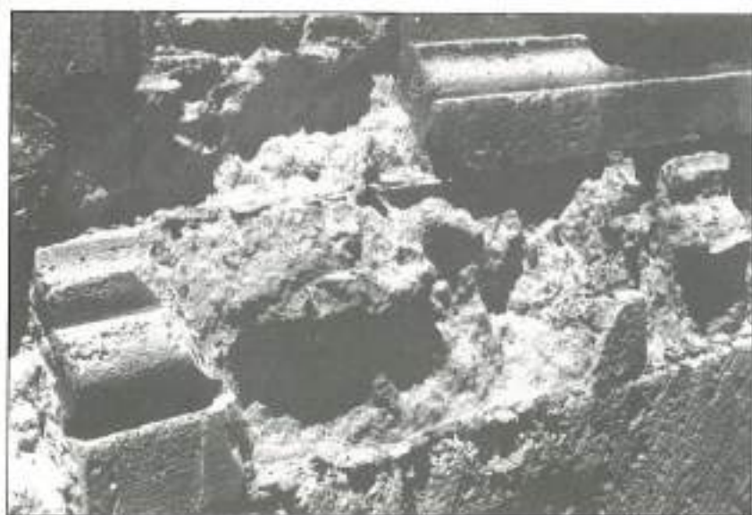
FIGURA 10. Pérdida generalizada de material. Arentzación.
