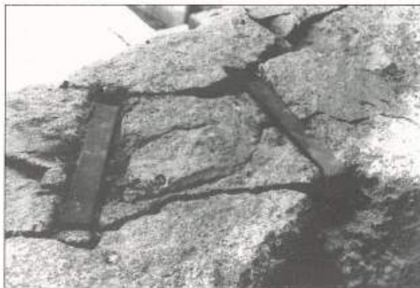
FIGURA 9. Detalle de la fisuración del tercer cuerpo de la torre bajo el campanario. Fachada sur.
