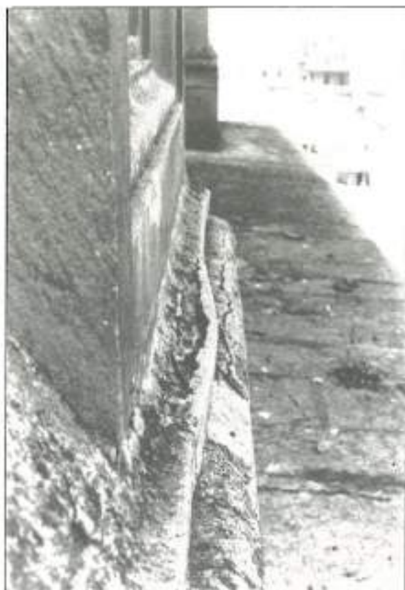
FIGURA 11. Deterioro de una moldura por cristalización de sales. Fachada este.
