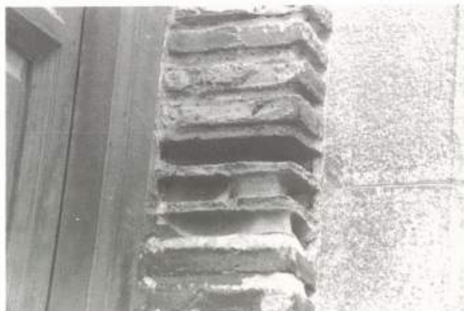
FOTO 6. Alcázar de Toledo. Disgregación del ladrillo.
