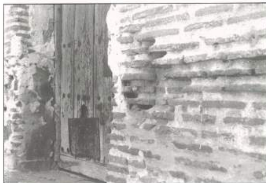
FOTOS 2 y 3. Hospital de San Juan, Medina del Campo (Valladolid). El agua asciende por capilaridad y ataca al mortero y al ladrillo produciendo la desintegración de ambos.
