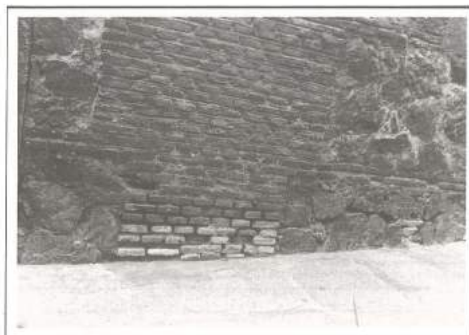
FOTO 4. Alcázar de Toledo. Desintegración de las morteras de las juntas y desconchamiento superficial de los ladrillos.
