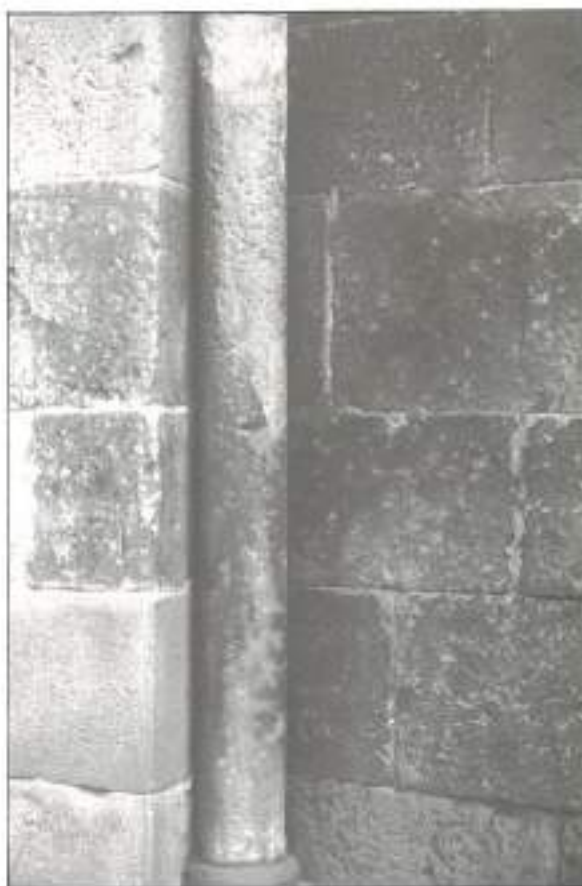
FIGURA 9. Detalle de exarriaciones, impactos y picaduras con pérdida de material.
