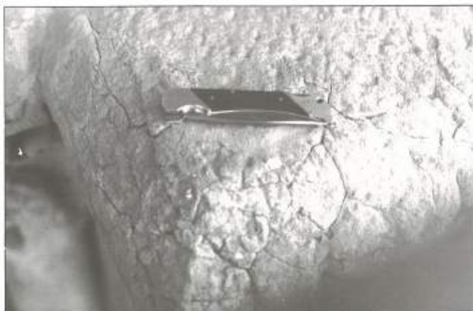
FIGURA 7. Procesos de helo-deshielo. Capitel de una de las columnas del pórtico.
