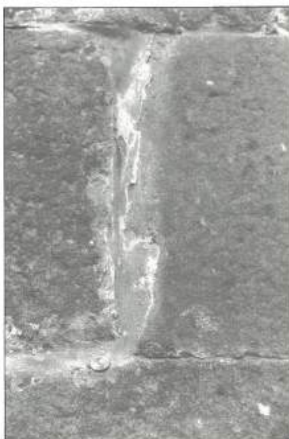
FIGURA 8. Detalle de alteración y ornización de un mortero de restauración utilizado entre dos sillares de la fachada.
