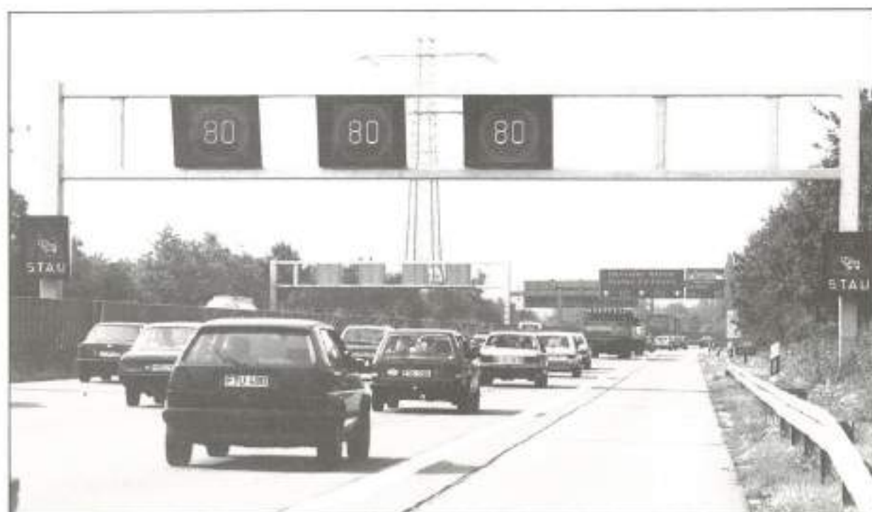
FOTO 2. Señales de fibra óptica utilizadas para control de carriles y aviso de peligros.
