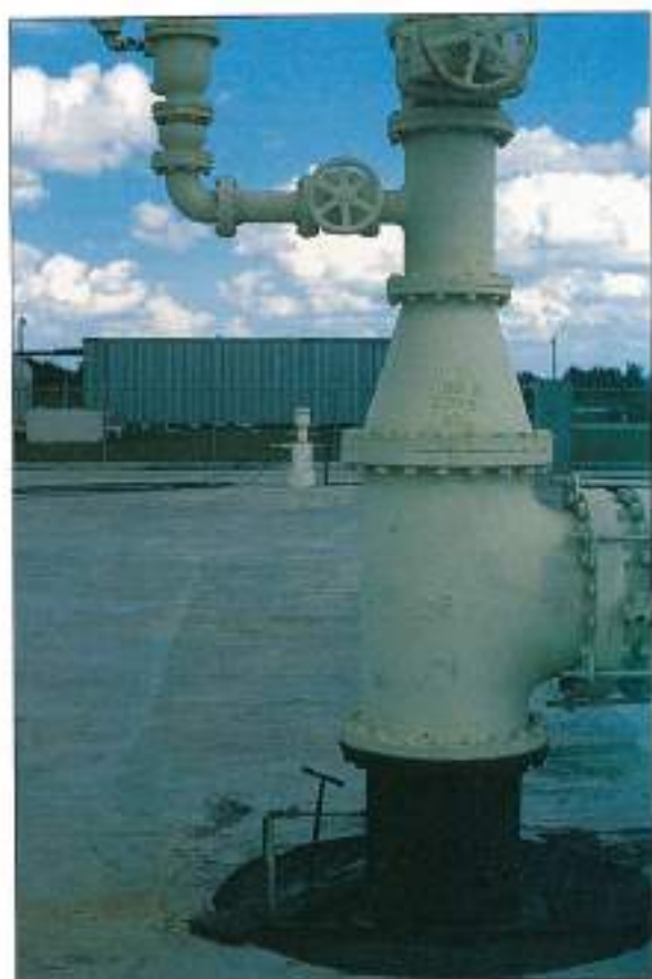
FOTO 1. Cabezal de inyección 500 l/s Florida, EE.UU.
