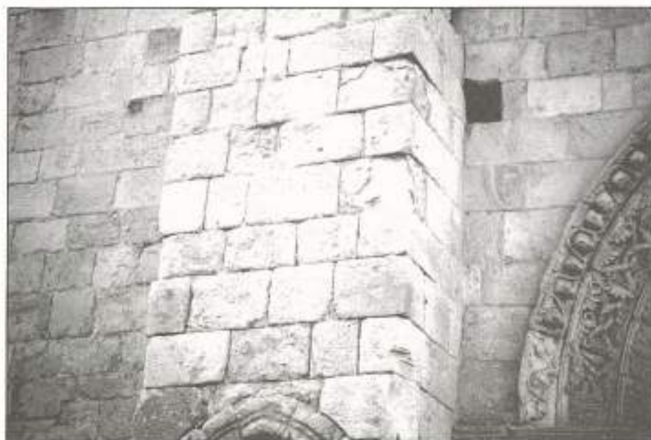
FOTO 3. Aspecto de un contrafuerte de la fachada sur de la Iglesia de la Magdalena donde se observan diversas formas de alteración que desarrolla la roca.
