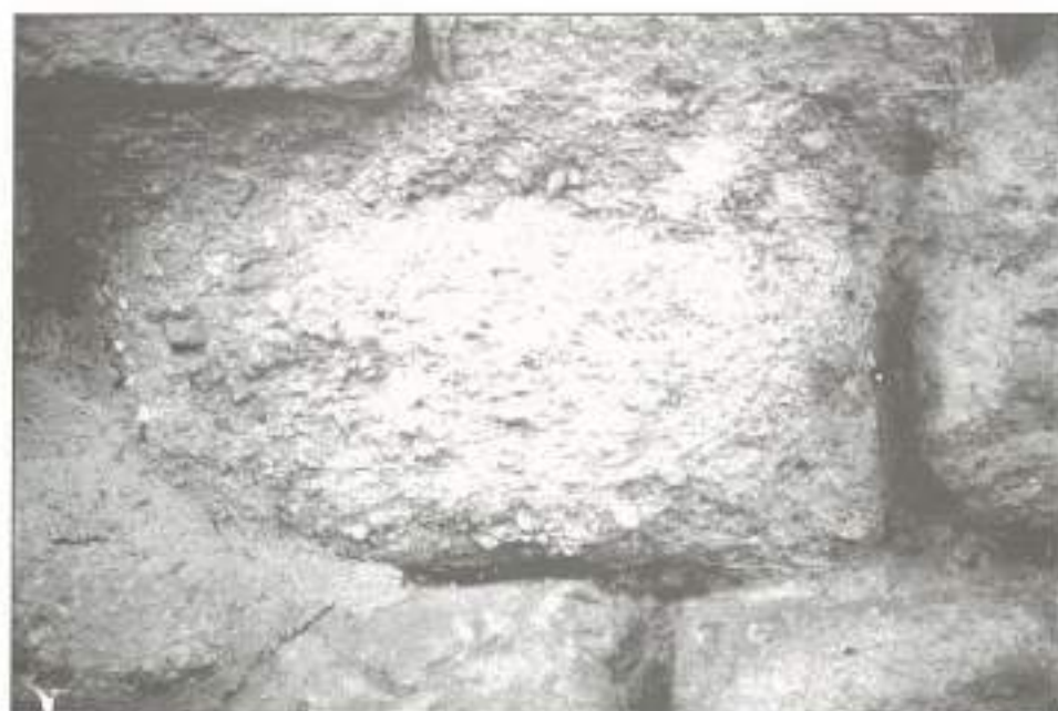
FOTO 4. Detalle de un sillar de la fachada este de la Catedral gravemente deteriorado por desmenución y desagregación granular.
