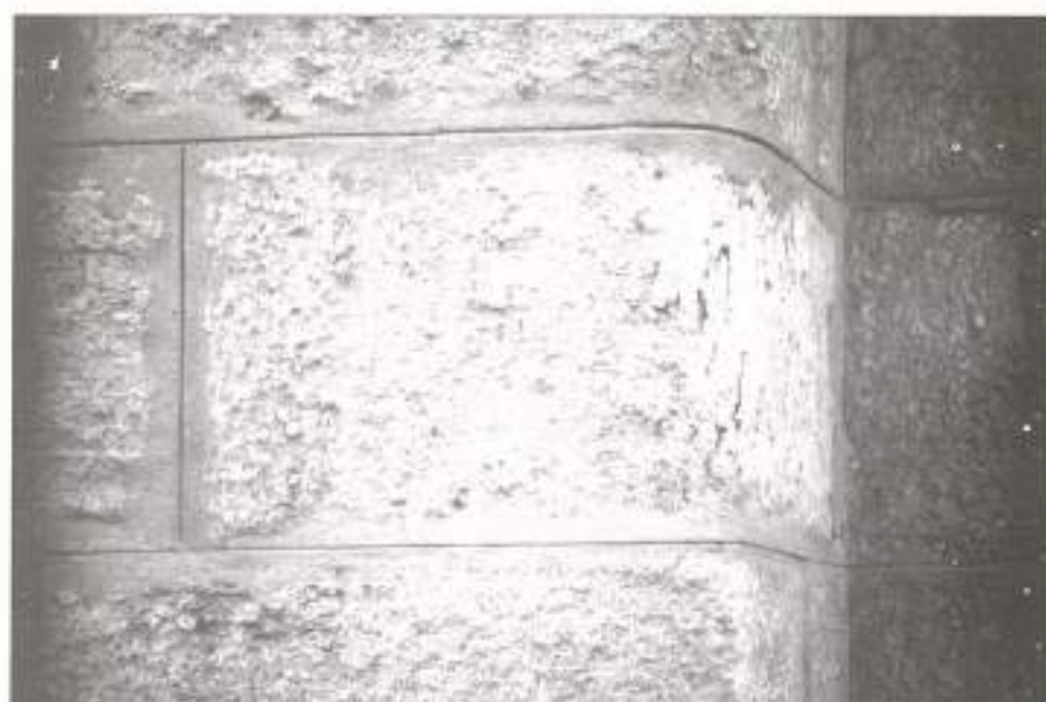
FOTO 5. Detalle de un sillar de la fachada sur de la Iglesia de la Magdalena que ha desarrollado diversas morfologías de alteración: desmenución, descamación, etc.
