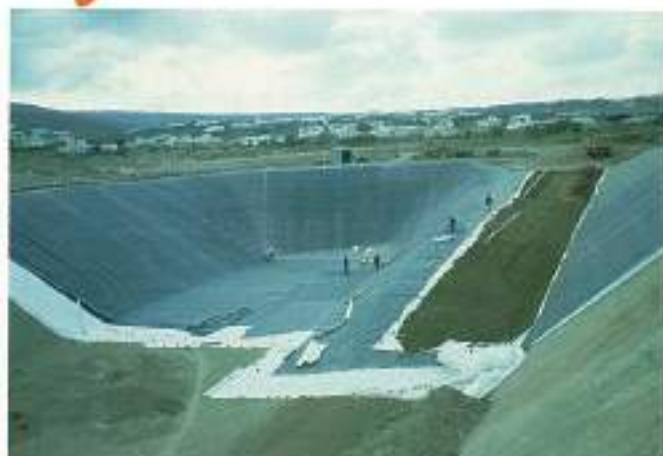
VERTEDERO DE RESIDUOS URBANOS - MELILLA
