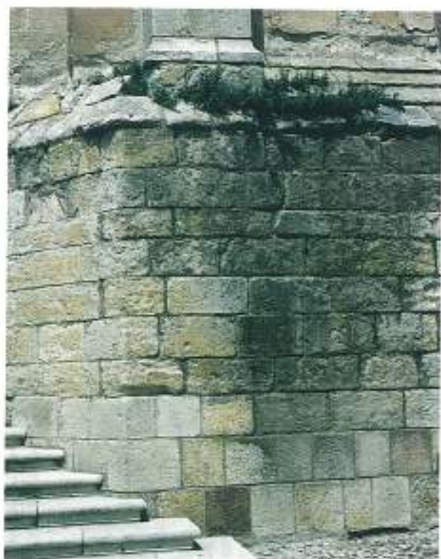
FOTO 1. Esquina SE de la Catedral donde se observa el extenso desarrollo de la patina naranja, excepto en los sillares de reciente sustitución; y sobre ella, la patina negra en una zona de acumulo de humedad donde han crecido plantas superiores.
