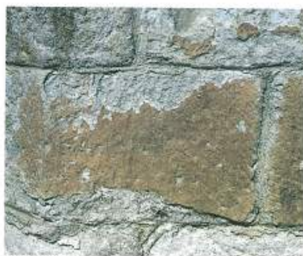
FOTO 2. Detalle de un sillar recubierto por la patina naranja que presenta el aspecto de una pintura, y que se ha desprendido en gran parte por descomposición.
