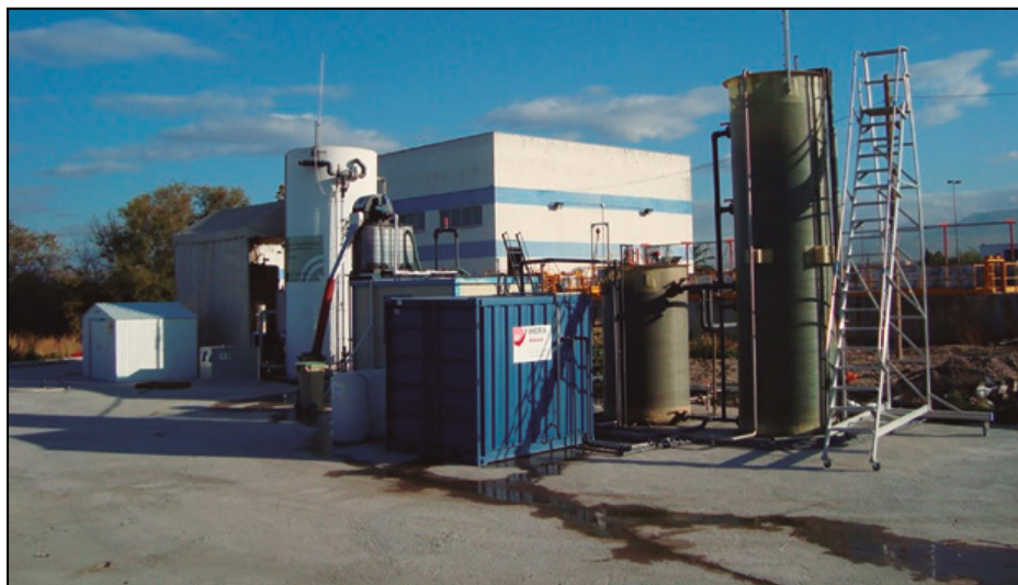
Figura 1. Visión general de la instalación experimental de microfiltración.
